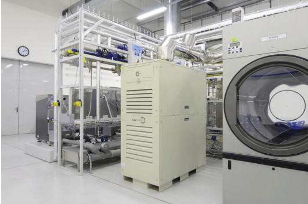
Obr. 1 Mikroturbína Capstone C30 integrována do infrastruktury LENP
