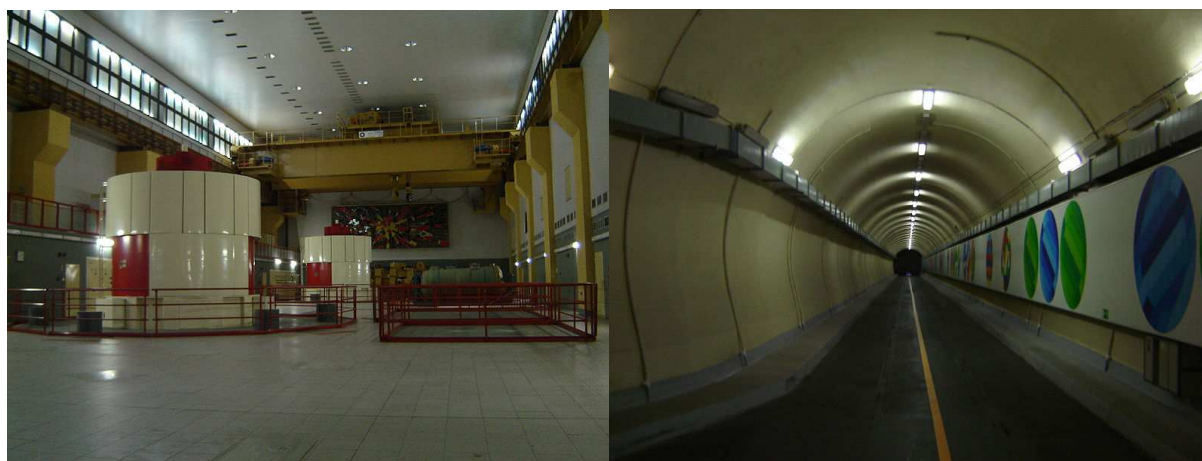
Obr. 15: Turbínový sál (vlevo) a tunel do turbínové kaverny (vpravo) (53)
