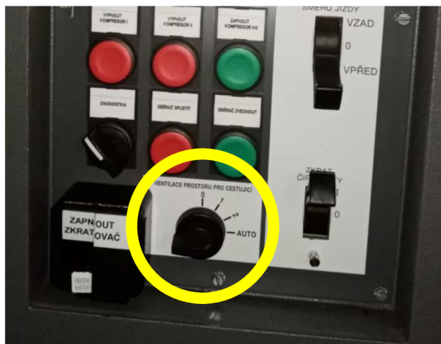
Obrázek 12 - Ovládání vzduchotechniky pro prostor cestujících
