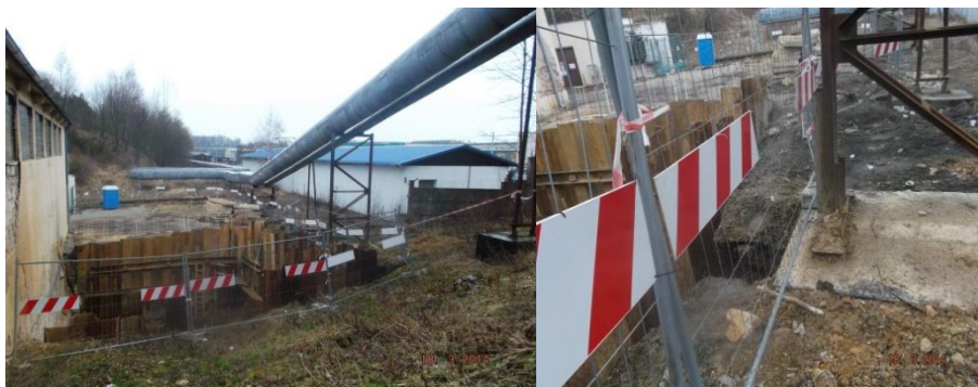
Obr. 9 – Ohrožení betonové patky parovodu 23
