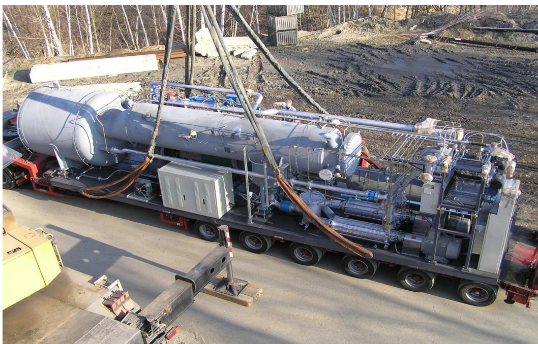
Obr. 10 Instalace modulu ORC v Trhových Svinech [20]
