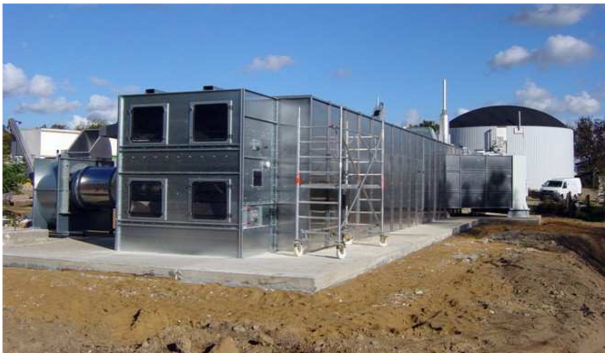
Obr. 13 Pásová sušárna digestátu, bioplynová stanice v Německu [16]
