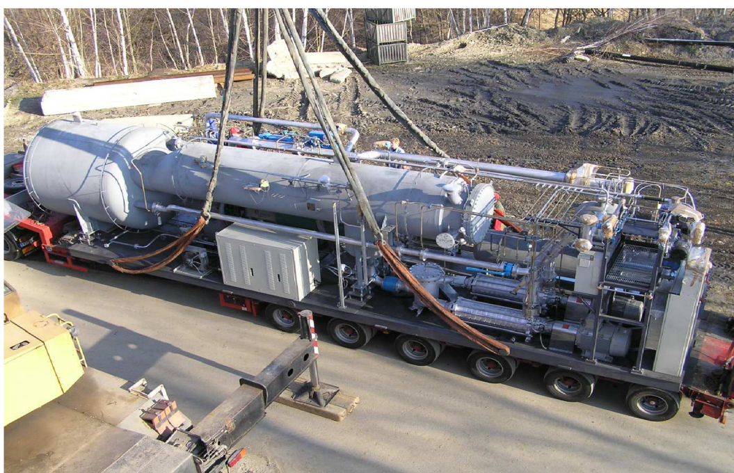
Obr. 10 Instalace modulu ORC v Trhových Svinech [20]
