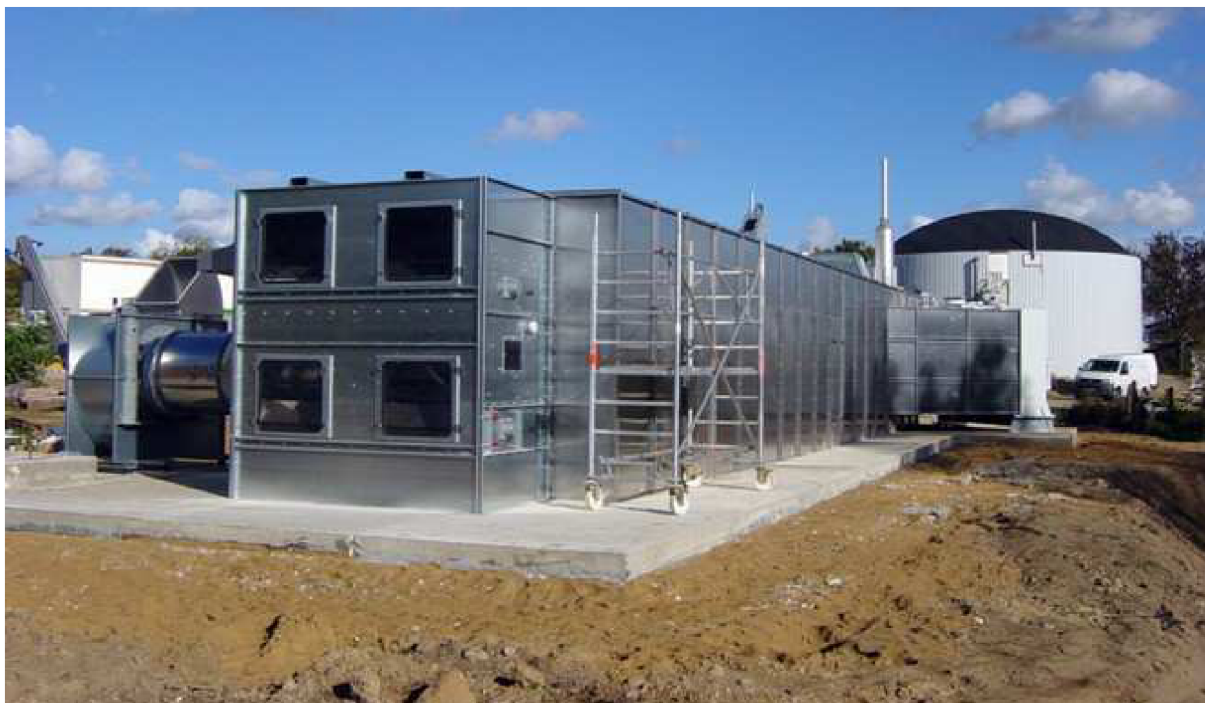
Obr. 13 Pásová sušárna digestátu, bioplynová stanice v Německu [16]
