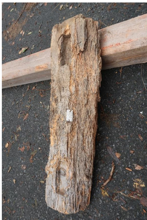
Obr. 3.9.6: Výletové otvory způsobené dřevokazným hmyzem.
