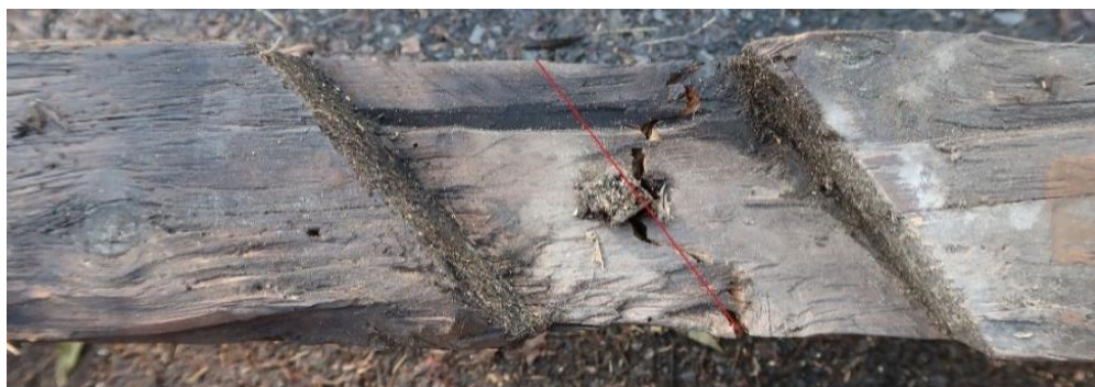
Obr. 5.1.299: Detail označení místa konstrukční sanace – protéza 3,4 m.
