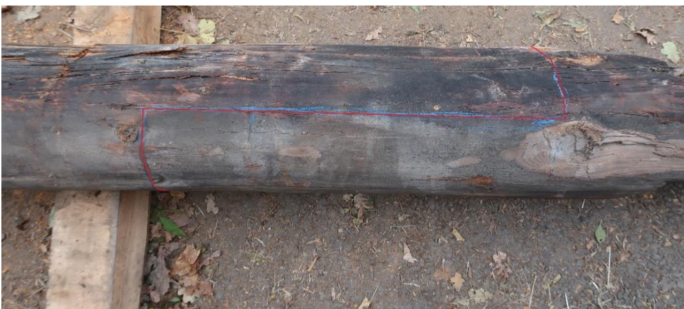
Obr. 5.1.23: Detail označení místa konstrukční sanace – protéza 1,5 m.
