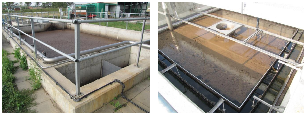
Obr. 3.9a, b. Pohled na aktivační nádrž (a) a na dozovací nádrž (b) ČOV Starovice
