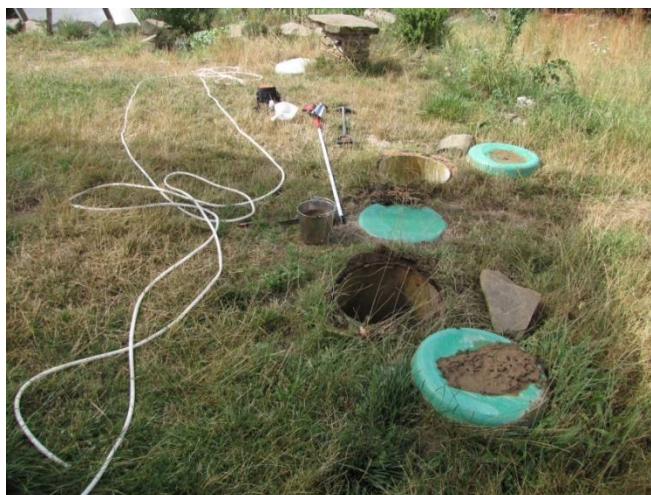
Obr. 4.3. Příklad sledovaného biologického vícekomorového septiku domovní kořenové ČOV – umístění na pozemku, přístupové otvory
