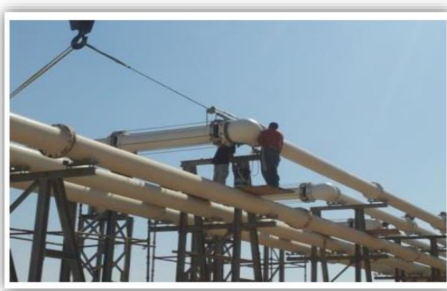
Obrázek číslo 6: Stavba zapouzdřené rozvodny v Saudské Arábii v provincii Al Madinah [12]
