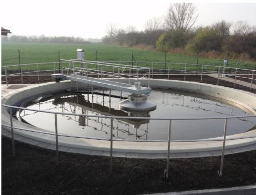
Obrázek č.: 8 Dosazovací nádrž (Šebesta ©2021)
