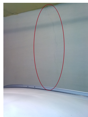
Obr. 3.3: Vlásočnicová trhlina v garážach
