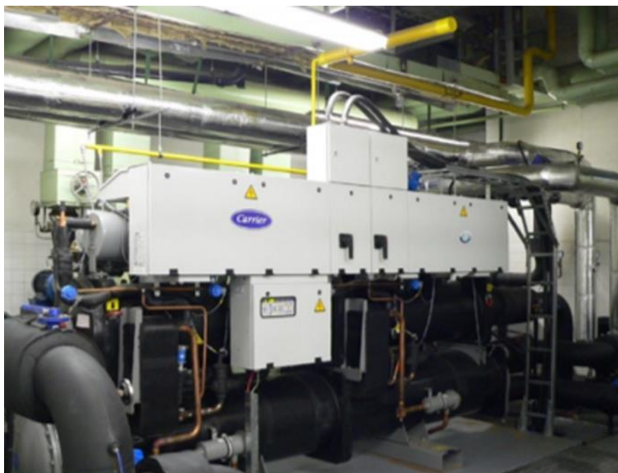
Obr. 3: Reverzní chladicí stroj Carrier využívající teplo z vltavské vody [10].
