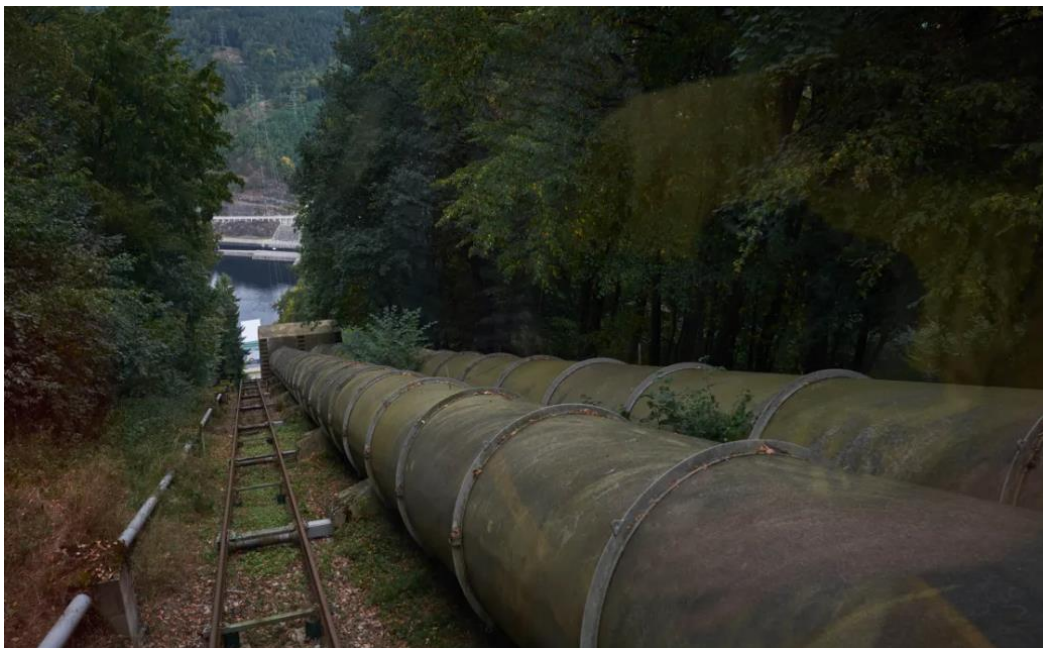
Obr. 8 Ocelové tlakové potrubí přečerpávací vodní elektrárny Štěchovice [3]
