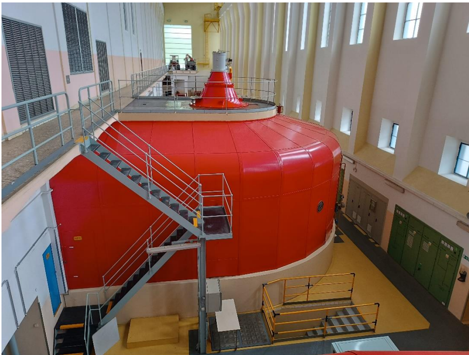
Obr. 10 Generátor vodní elektrárny Štěchovice [vlastní]
