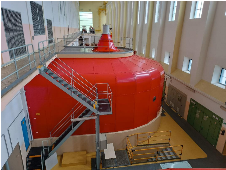
Obr. 10 Generátor vodní elektrárny Štěchovice [vlastní]
