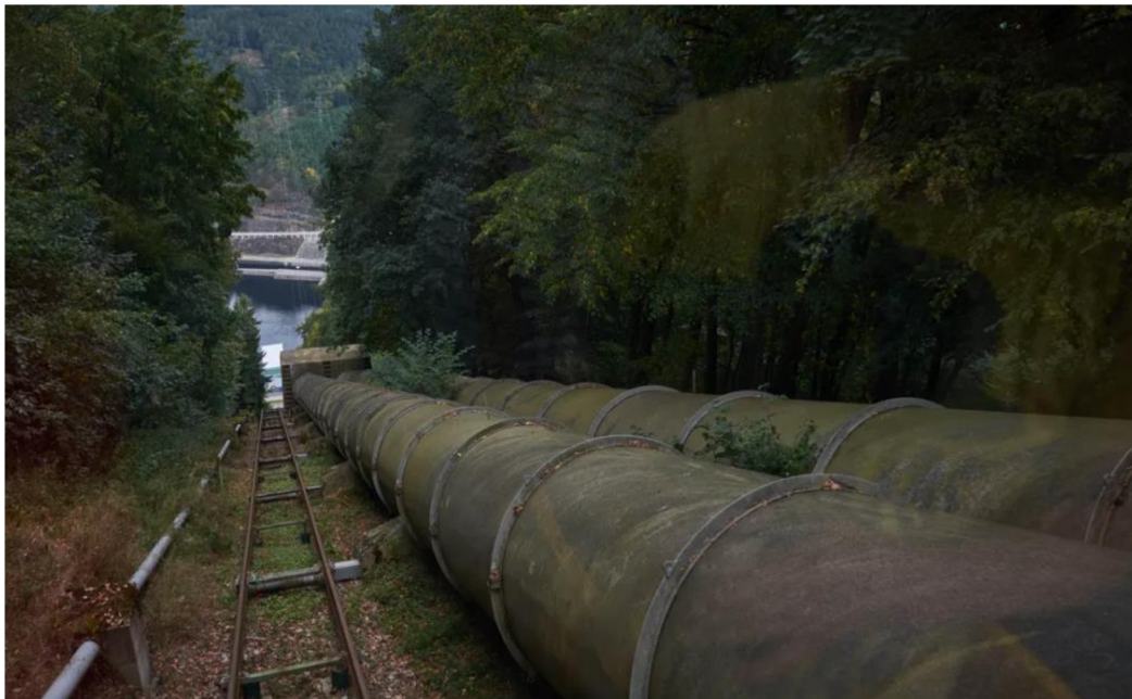
Obr. 8 Ocelové tlakové potrubí přečerpávací vodní elektrárny Štěchovice [3]
