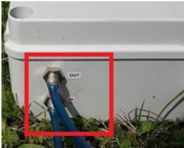
Obr. 11 – Vstupní a výstupní hadičky na kontrolní jednotce
