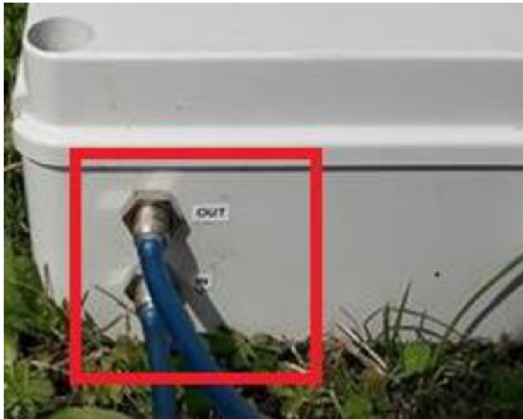
Obr. 11 – Vstupní a výstupní hadičky na kontrolní jednotce
