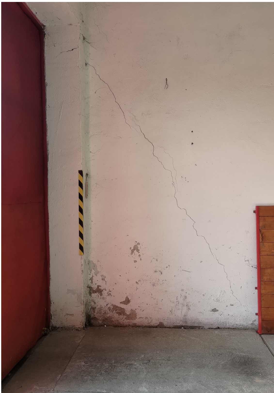
Obr. 4.6: Výrazná trhlina v rohu zbrojnice
