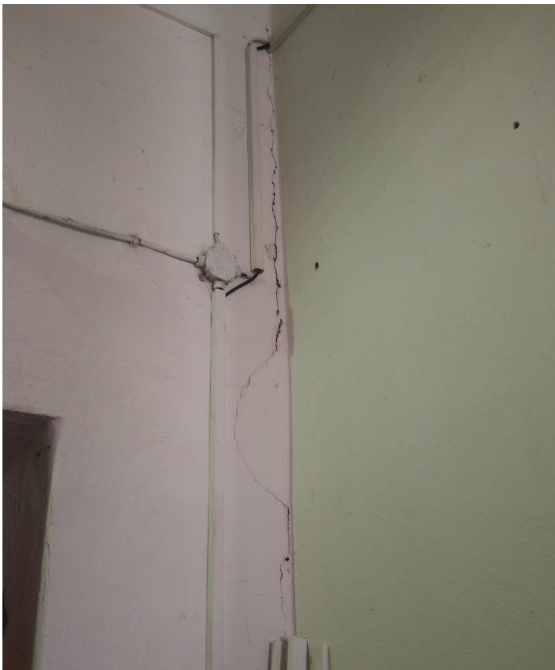
Obr. 4.18: Trhlina v zadním rohu
