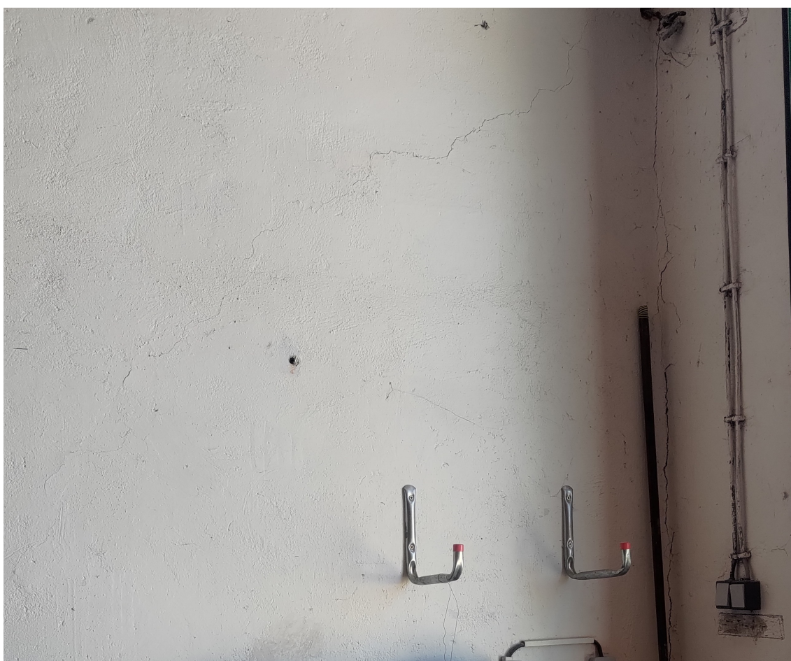
Obr. 4.16: Trhlina ve stěně šatny pohled z garáže
