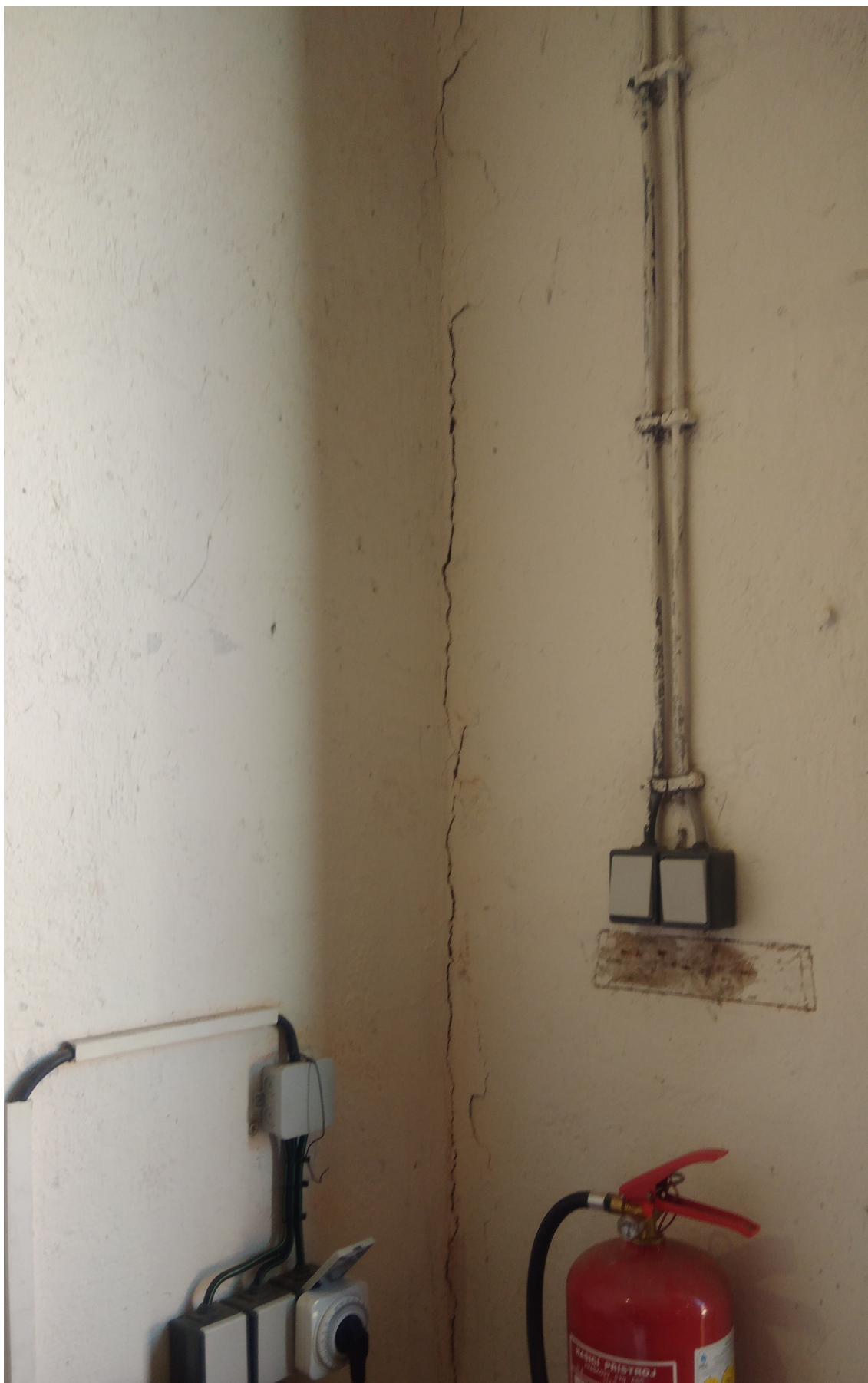
Obr. 4.17: Trhlina v protějším rohu
