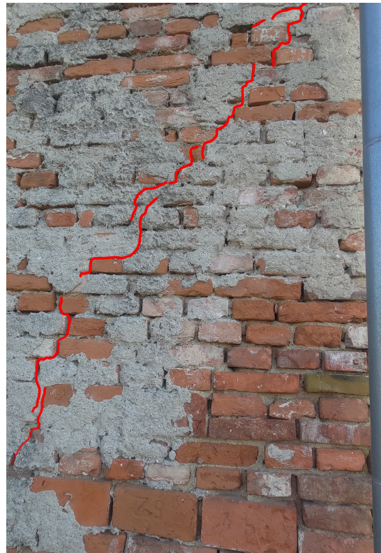
Obr. 4.8: Detail trhliny z vnější strany
