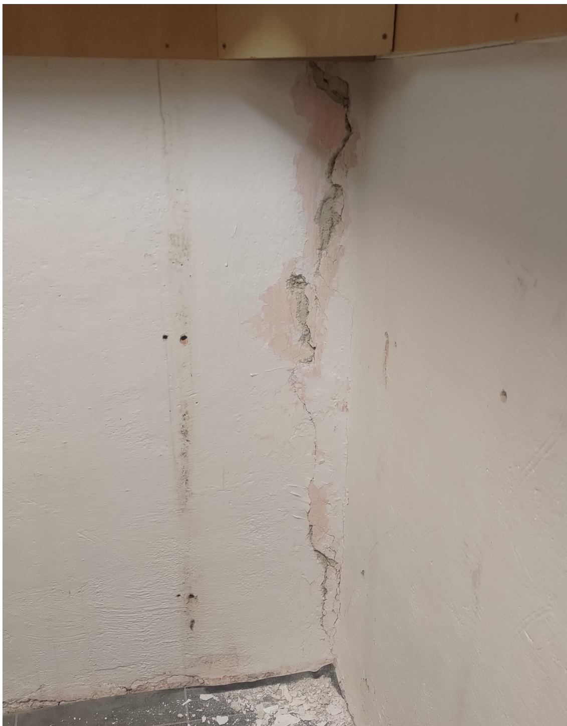
Obr. 4.19: Trhlina v rohu šatny
