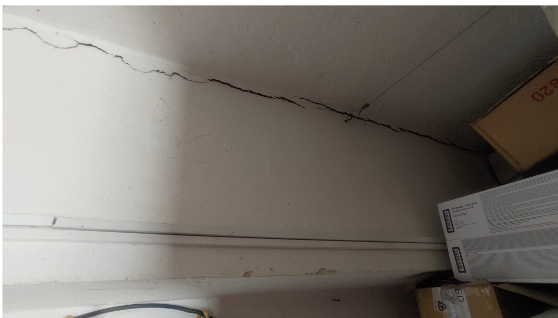
Obr. 4.9: Trhlina 2 - styk průvlaku a stropních panelů
