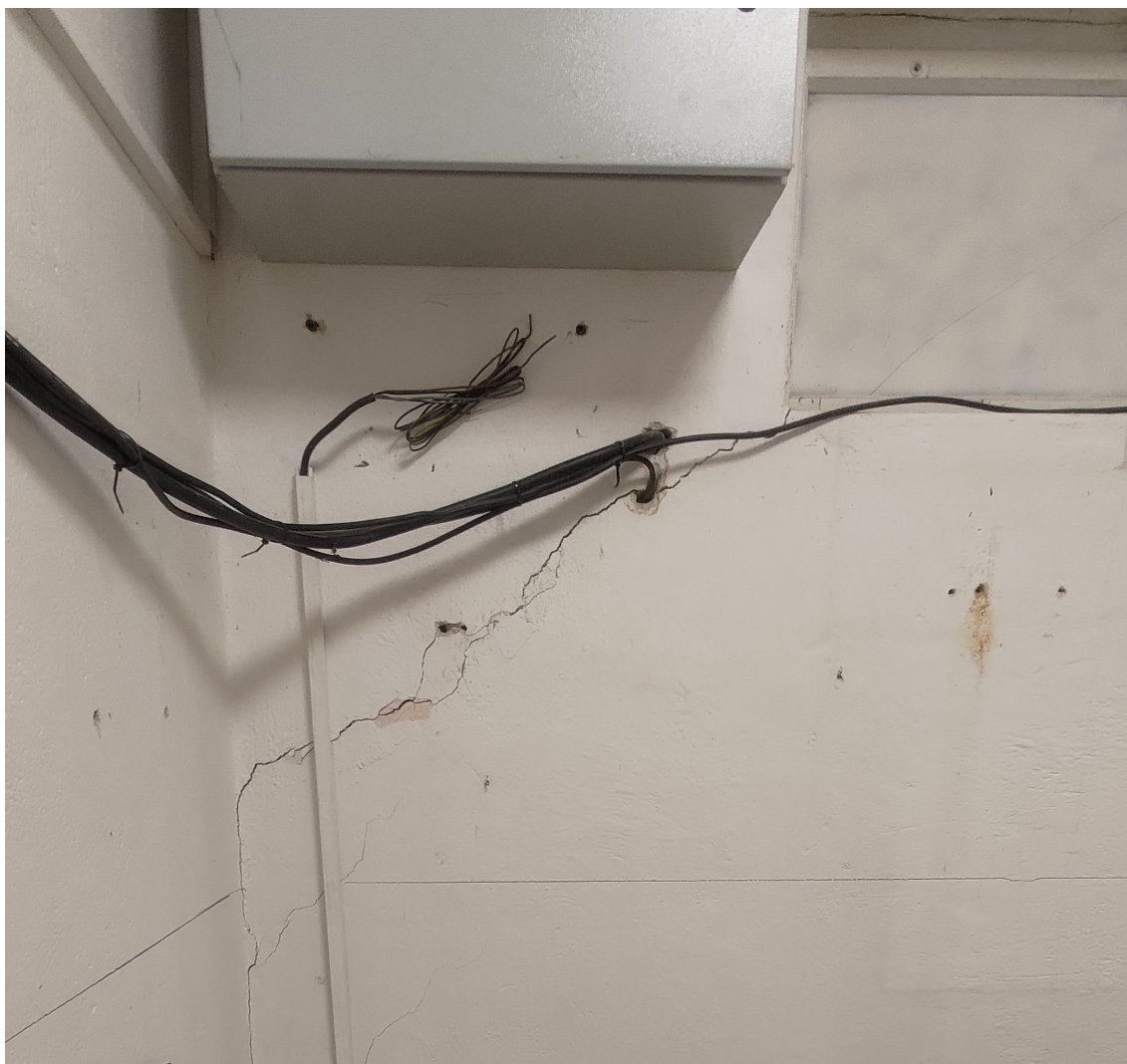
Obr. 4.20: Trhlina pod oknem
