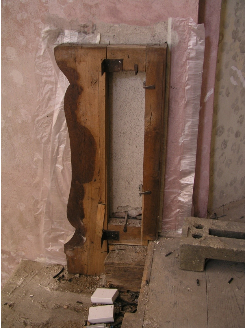
Obr. č. 30 Rám k uchycení konstrukce zábradlí – stav v průběhu restaurování, po demontáži zábradlí 35
