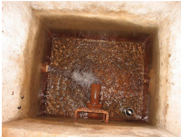
Obr. 3.9 Sběrná jímka v Albrechticích [15]
