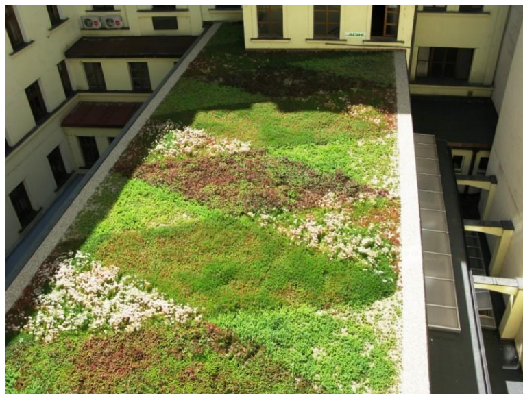
Obrázek 9: Extenzivní střešní zahrada od firmy Acre na střeše Sportcentra YMCA v Praze (zdroj: http://www.acre.cz/cs/menu/sluzby-a-realizace/realizace-zelenych-strech/zelene-strechy-extenzivni/ )
