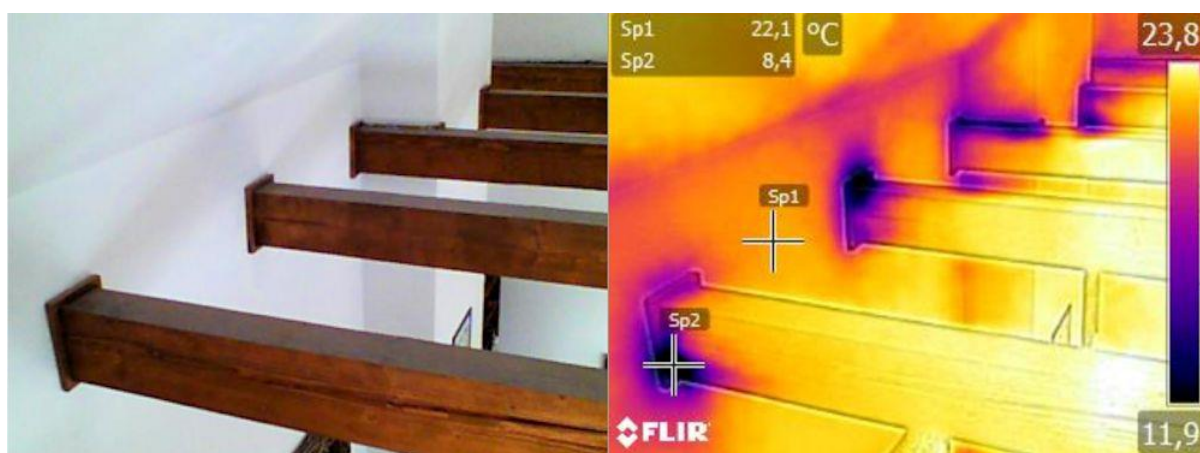
Obr. 1 Tepelné mosty v okolí styku trámové konstrukce a stěny
