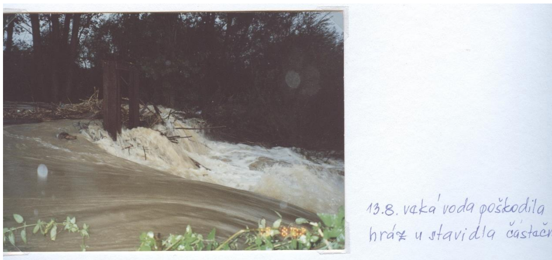
Obrázek C2: Fotodokumentace povodně – hráz u stavidla (zdroj: soukromý archiv Josefa Červeného)
