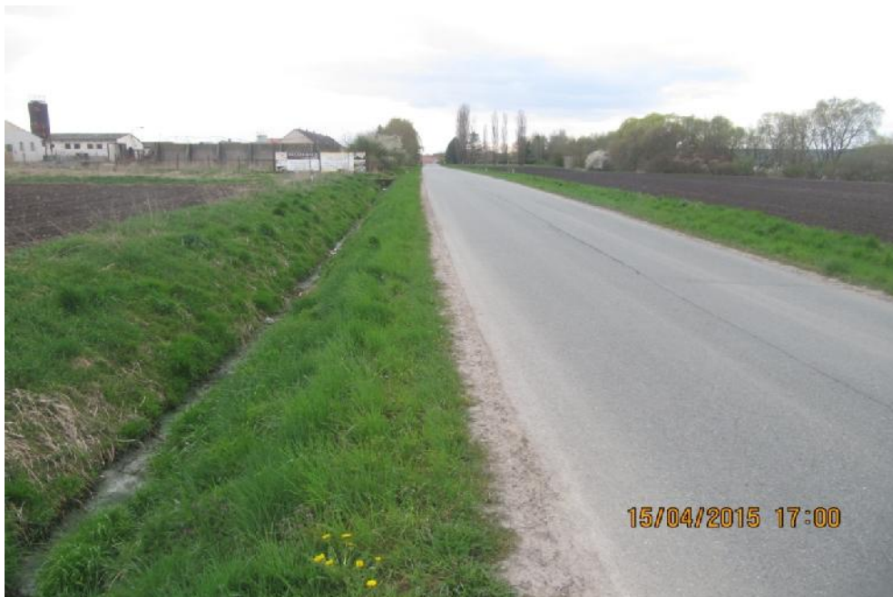
Obr. 11 Odvod ovací p íkop u silnice III/32815 Cho ovice (autor)
