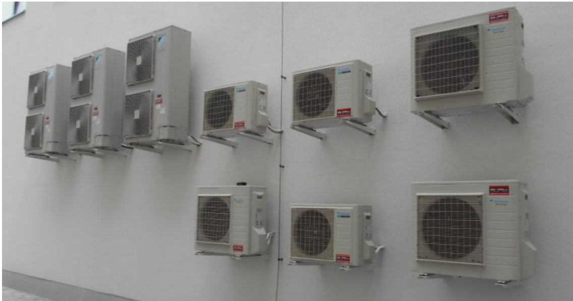
Obrázek č. 4: Klimatizační jednotky Daikin montované společností Faksa-Straka, s. r. o. (Zdroj: 2).
