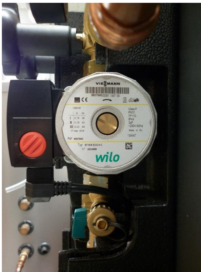
Obr. 27 Čerpadlo solárního okruhu [vlastní zdroj]
