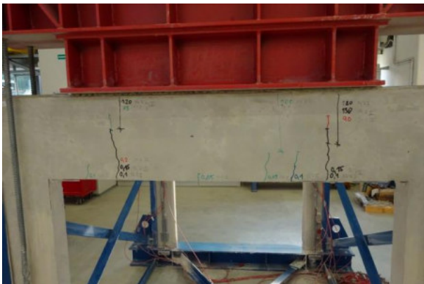
a) Rozšíření stávající trhliny a vznik dalších trhlín
