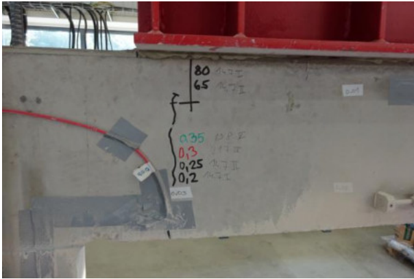
a) Rozšíření stávající trhliny
