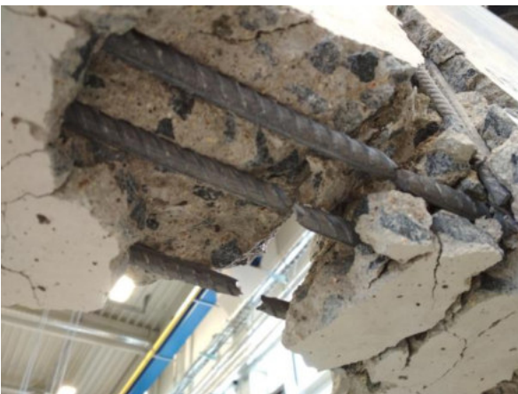
Obr. 6.67 Přerušené pruty v nadpraží – panel S2.II
