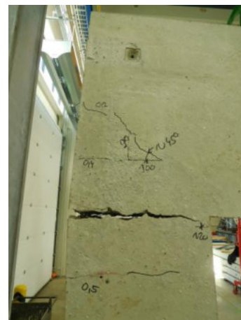
Obr. 6.64 Trhliny v pilíři – panel S1.II
