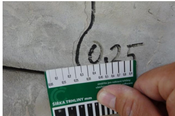
Obr. 6.13 Odečet šířky trhliny
