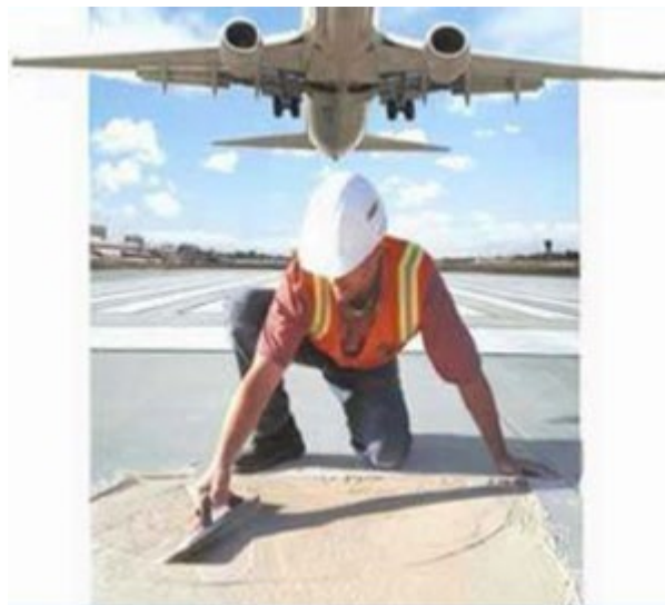
Obr. č. 6 – Aplikace geopolymerního přípravku Ecopatch indické firmy Ashramecements při opravě přistávací dráhy (převzato z WWW:< http://www.ashramecements.com >)
