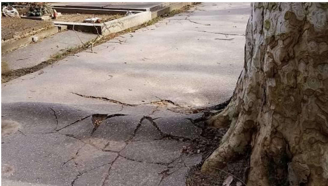
Obrázek 6 - poškození chodníku kořeny stromu (Deník ©2020)
