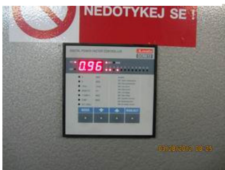
obrázek 12 – Regulátor jalového výkonu RM9612
