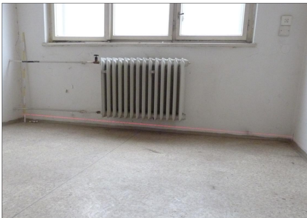
Obrázek 4.3-4 Naměřený výškový rozdíl podlah v 3.NP dokazující nerovnoměrné sednutí části přístavby budovy ze 40. let [41]
