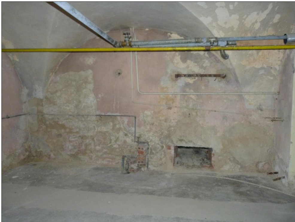
Obrázek 4.3-1 Vlhkost stěn v 1. NP budovy se projevuje drolením a odpadáváním degradované vápenné omítky [41]
