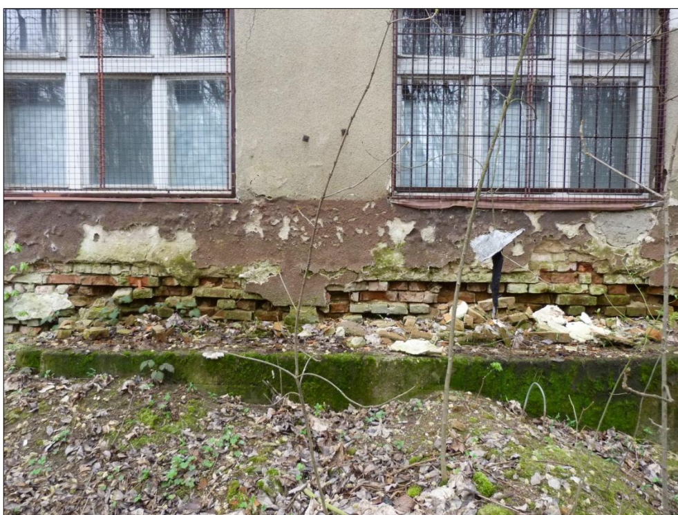
Obrázek 4.3-12 Obnažené zdivo na severní část stavby ze 40. let porušené vlhkostí a mrazem [41]
