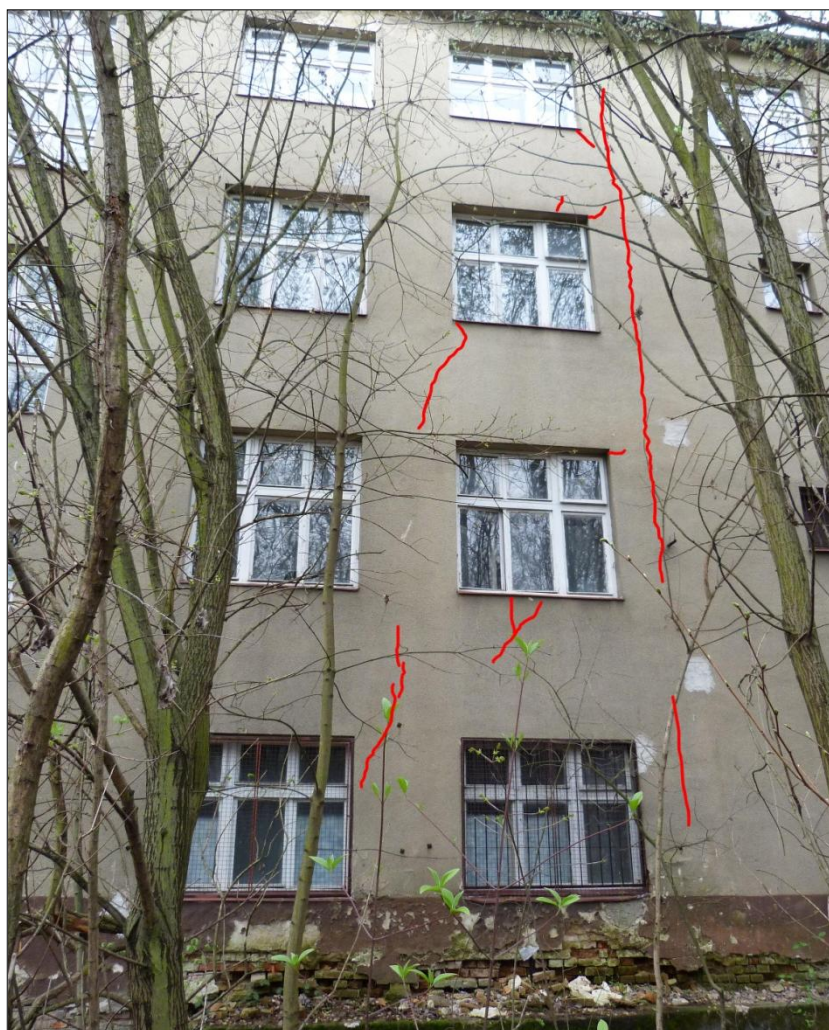
Obrázek 4.3-7 Obvodové nosné zdivo (severní strana stavby). Trhliny dokazují sednutí budovy směrem k nedokončené přístavbě z r. 1997 (vpravo). Svislá trhlina je v místě nedokonalého napojení části stavby z r. 1921 a přístavby ze 40. let.[41]
