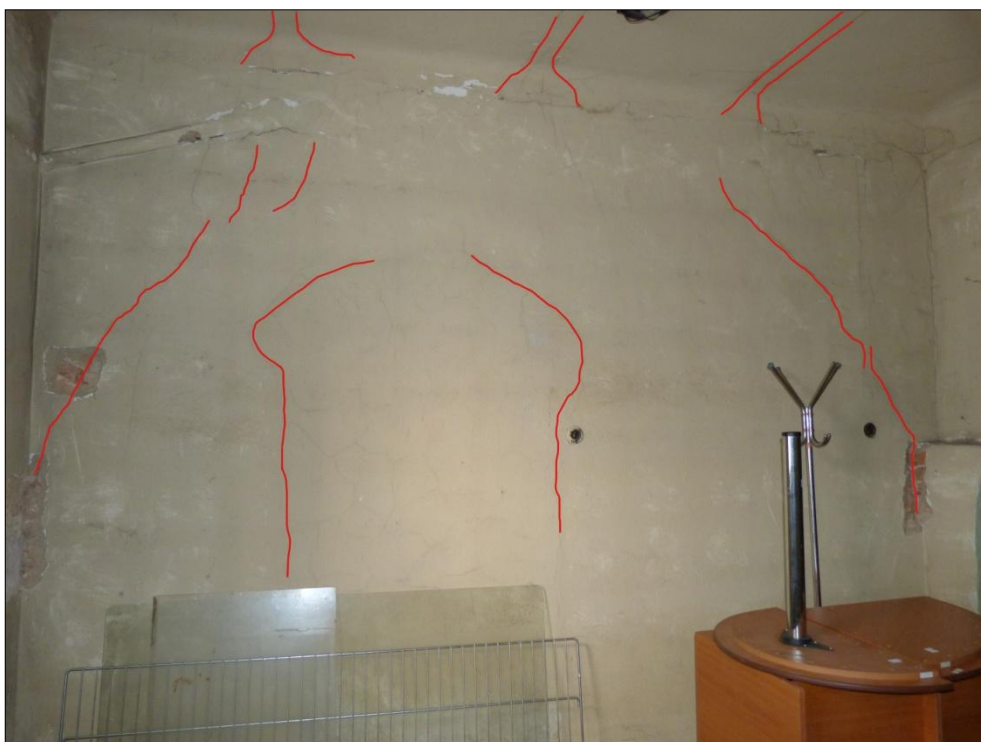
Obrázek 4.3-2 Prokopírované drobné trhliny ukazují, že původní otevřený klenbový prostor byl dodatečně zazděn a byl v něm zanechán pouze otvor pro dveře, který byl opět v další stavební fázi zazděn. Na novějším železobetonovém stropě lze vidět prokopírované trhliny od ocelových profilů a roznosu zatížení. [41]
