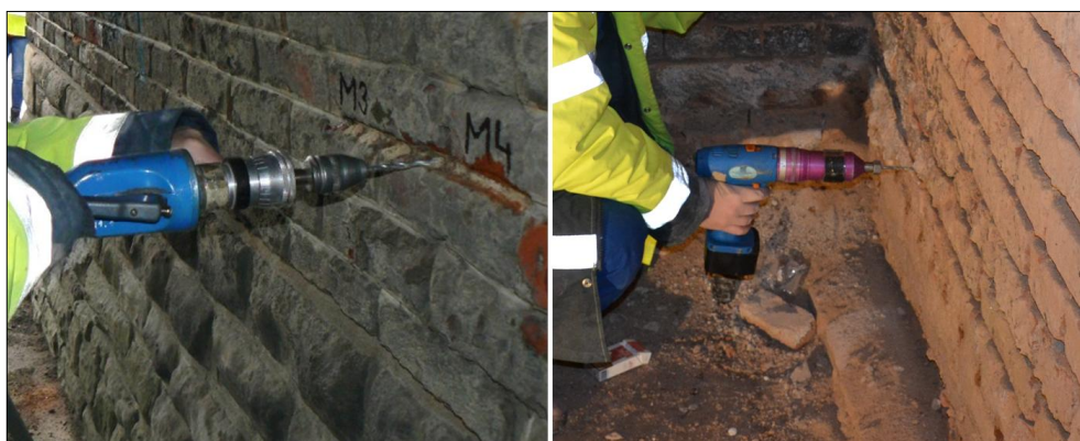
Obrázek 3.3.2-3 Příklad stanovení pevnosti malty cihelného zdiva pomocí Kučerovy vrtačky, vlevo ruční, vpravo elektrické [42]
