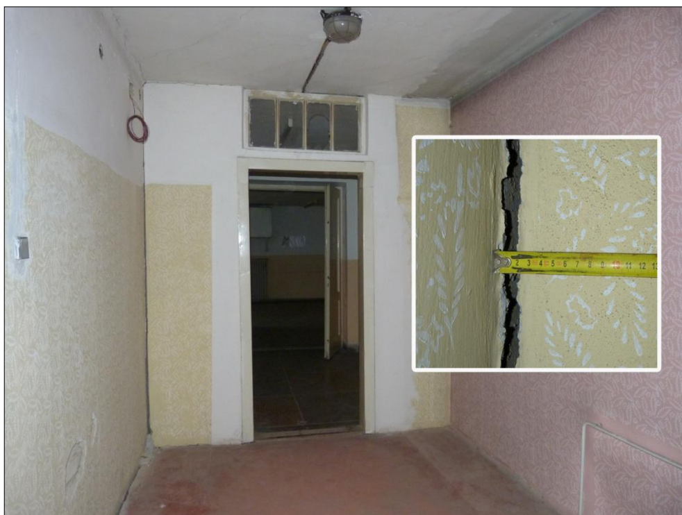
Obrázek 4.3-5 Spára ve 4. NP v úrovni napojení konstrukce podlahy, nosné zdi (tl. 300 mm) a příčky vlivem sednutím budovy v roce 1997. Na detailu šířka trhliny 30 mm mezi zdí a příčkou. [41]
