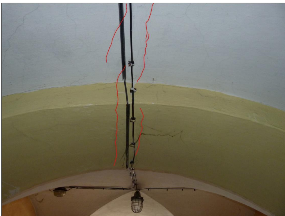
Obrázek 4.3-3 Drobné trhliny v omítce ve vrcholu klenby 1. NP [41]
