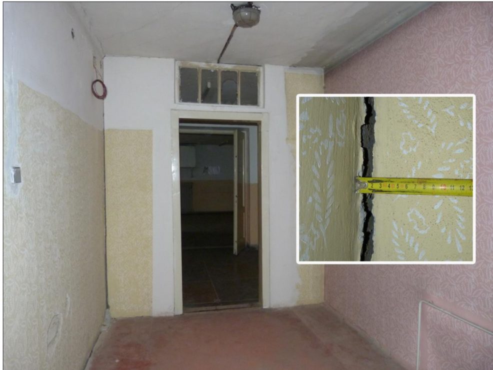
Obrázek 4.3-5 Spára ve 4. NP v úrovni napojení konstrukce podlahy, nosné zdi (tl. 300 mm) a příčky vlivem sednutím budovy v roce 1997. Na detailu šířka trhliny 30 mm mezi zdí a příčkou. [41]
