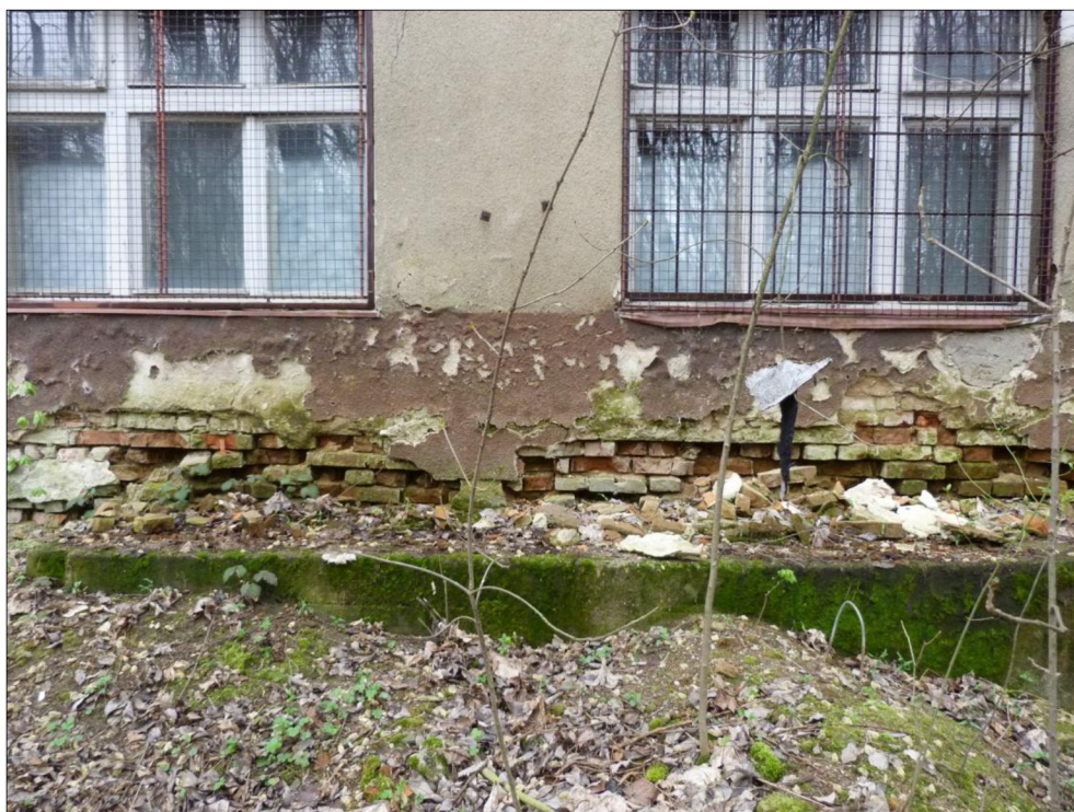
Obrázek 4.3-12 Obnažené zdivo na severní část stavby ze 40. let porušené vlhkostí a mrazem [41]
