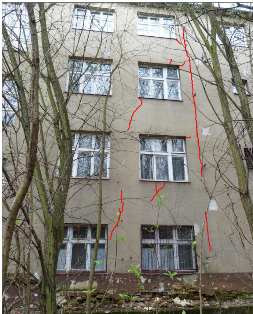
Obrázek 4.3-7 Obvodové nosné zdivo (severní strana stavby). Trhliny dokazují sednutí budovy směrem k nedokončené přístavbě z r. 1997 (vpravo). Svislá trhlina je v místě nedokonalého napojení části stavby z r. 1921 a přístavby ze 40. let.[41]
