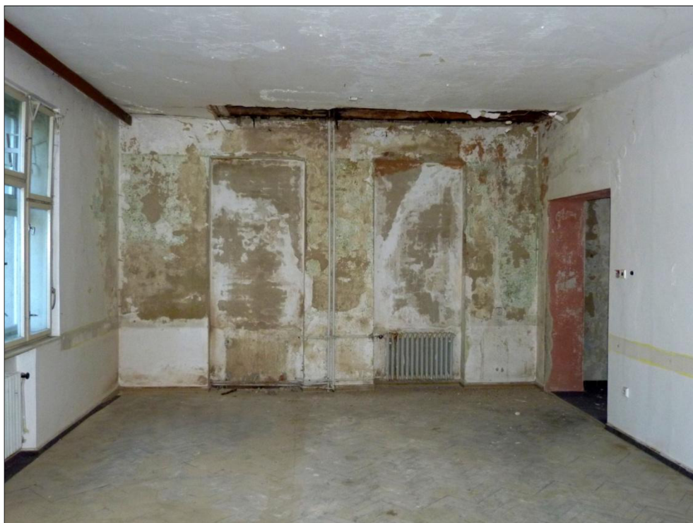
Obrázek 4.3-8 Pohled v bývalé jednací síni soudu v 2. NP na severní zed' budovy. Zatékání v místě připojení nedokončené přístavby prostoupilo přes 3. NP a dvě stropní konstrukce až na úroveň podlahy v 2. NP. V horní části je již vidět odstraněná část shnilé stropní konstrukce. [41]
