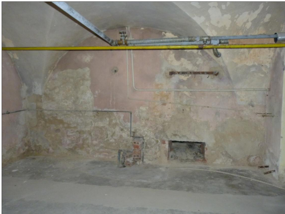
Obrázek 4.3-1 Vlhkost stěn v 1. NP budovy se projevuje drolením a odpadáváním degradované vápenné omítky [41]
