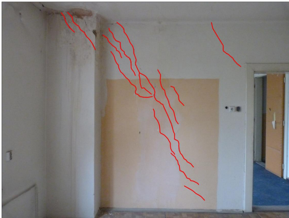
Obrázek 4.3-6 Četné trhliny ve 4. NP směřující k vnější obvodové (severní) stěně dokazující sednutí části budovy. [41]
