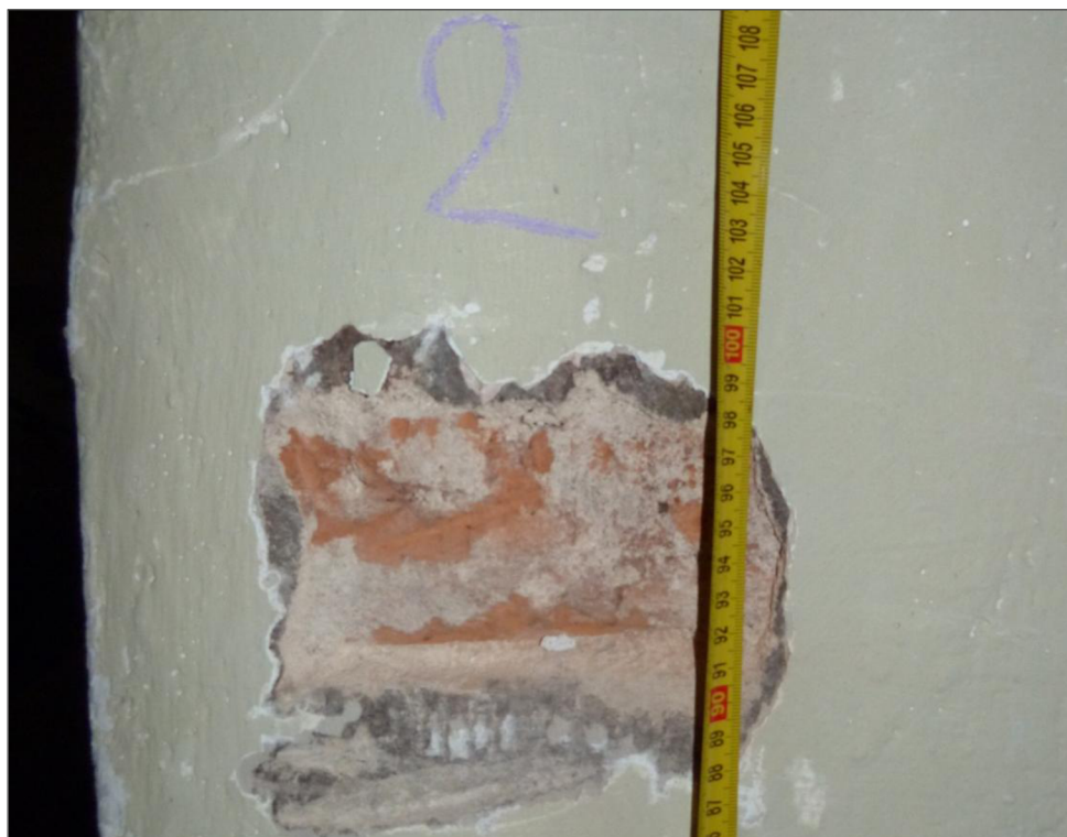
Obrázek 4.4.1-1 Sonda S2 v 1. NP v místě klenebního pilíře na rozhraní dvou materiálů – pískovcových kvádrů a pálených cihel. Svinovací metr ukazuje rozhraní těchto materiálů ve výšce od úrovně podlahy. [41]
