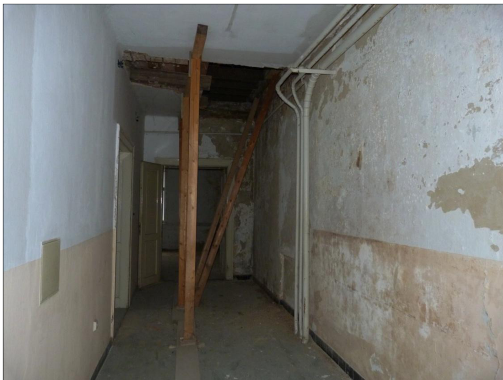
Obrázek 4.3-10 Provizorní podepření zbylé dřevěné trémové konstrukce stropu nad 3. NP v místě vyřezání nejpoškozenějších částí této konstrukce z důvodu zatékání vody na styku původní budovy a nedokončené přístavby z roku 1997. [41]
