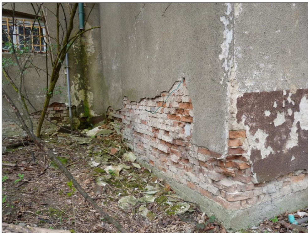
Obrázek 4.3-11 Obnažené zdivo na severovýchodní části stavby ze 40. let porušené vlhkostí a mrazem [41]
