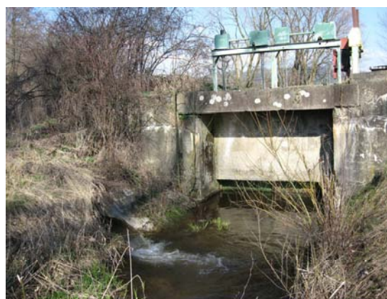
Foto 21: Dřevěné stavidlo Kremišovského jezu na ruční pohon. (P. Janků, 5.4. 2009)
