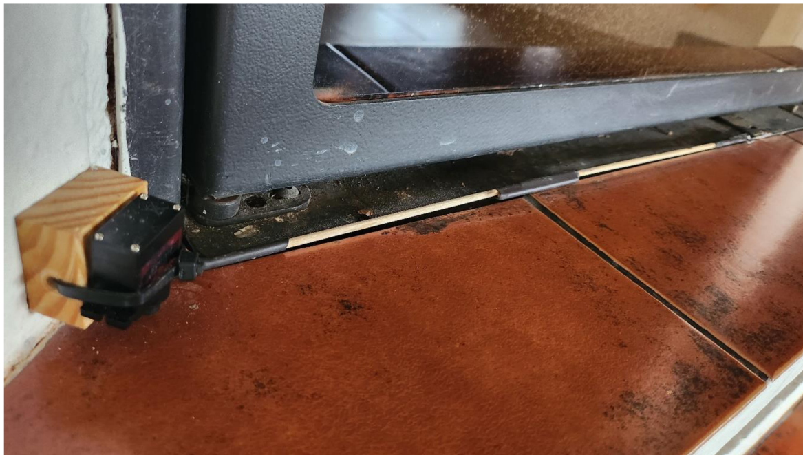
Obrázek 20: Fotodokumentace skutečného umístění servomotoru, který pomocí táhla reguluje pozici vzduchové klapky na topné soustavě
