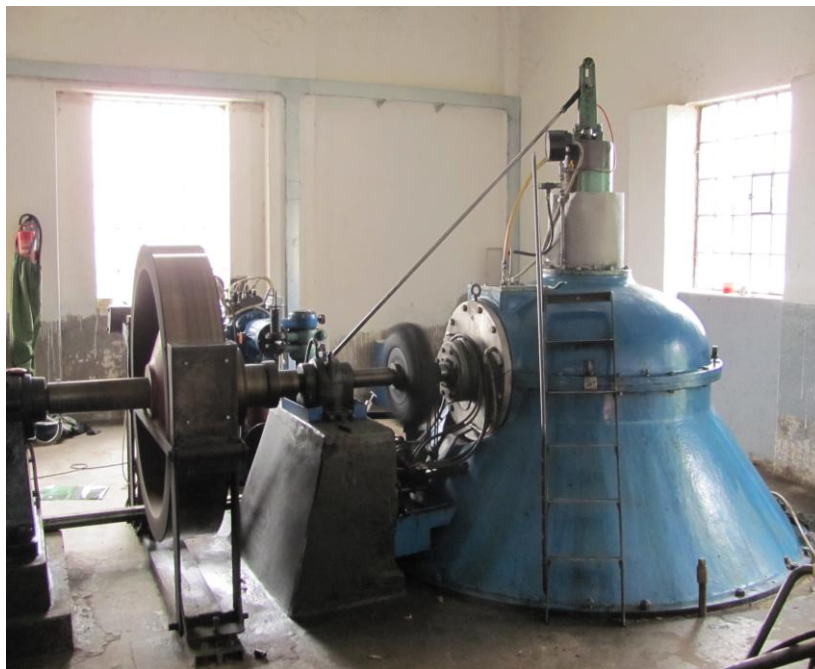
Obr. 17 - Kaplanova turbína v MVE Řevnice
