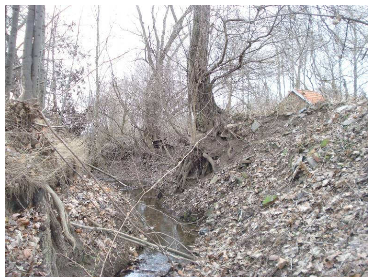
Foto 12 Sesunutí svahů, kořeny stávající vegetace (foto L.Zahradník)
