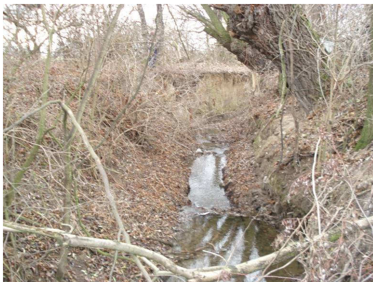
Foto 7 Poničené koryto potoka po směru toku, v pozadí svah 90° km 1,466 (foto L.Zahradník)
