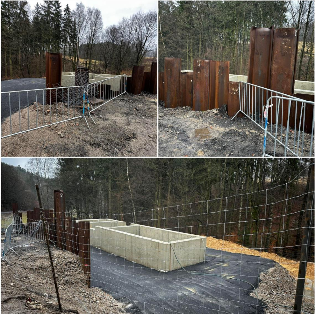
Obrázek 5: Současná realizace ČOV (zdroj: autorka 2024)
