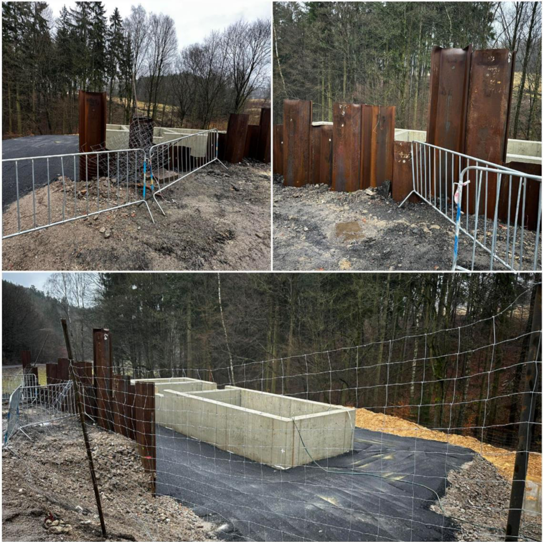
Obrázek 5: Současná realizace ČOV (zdroj: autorka 2024)
