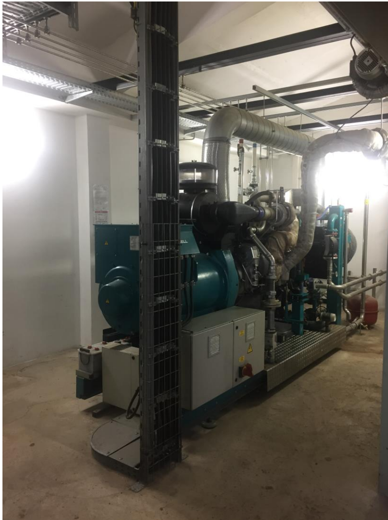
Obr. č. 13. Kogenerační jednotka ZS 265TC-V5. Foto: autor.
