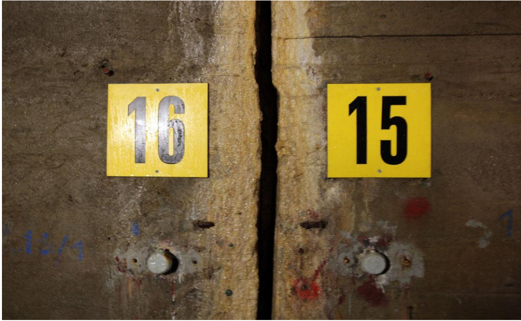
Obr. č. 5; Dilatační spára. Jedna mezi třiatřiceti betonovými bloky. Utěsněna je kaučukem z roku 1958. Vyměnit nejde (zdroj: http://zpravy.aktualne.cz )
