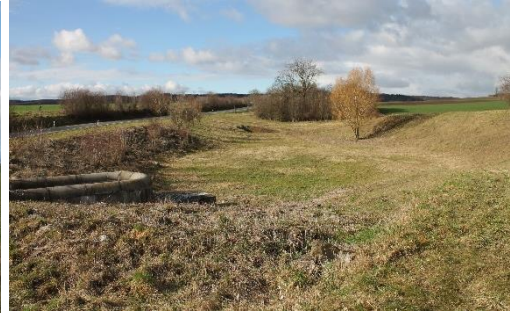
Obrázek 62: Suchá retenční nádrž
