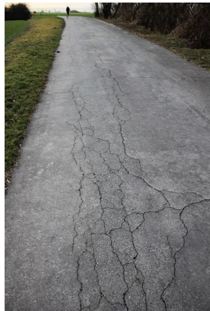
Příloha 16: Praskliny na cestě C1 v k.ú. Bobnice
