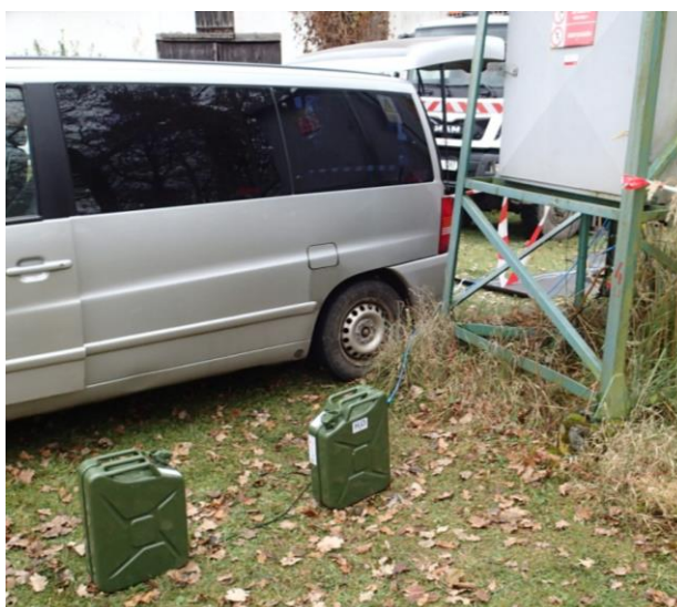
Obr. 9-10 Měření krokového napětí v blízkosti postižené DTS
