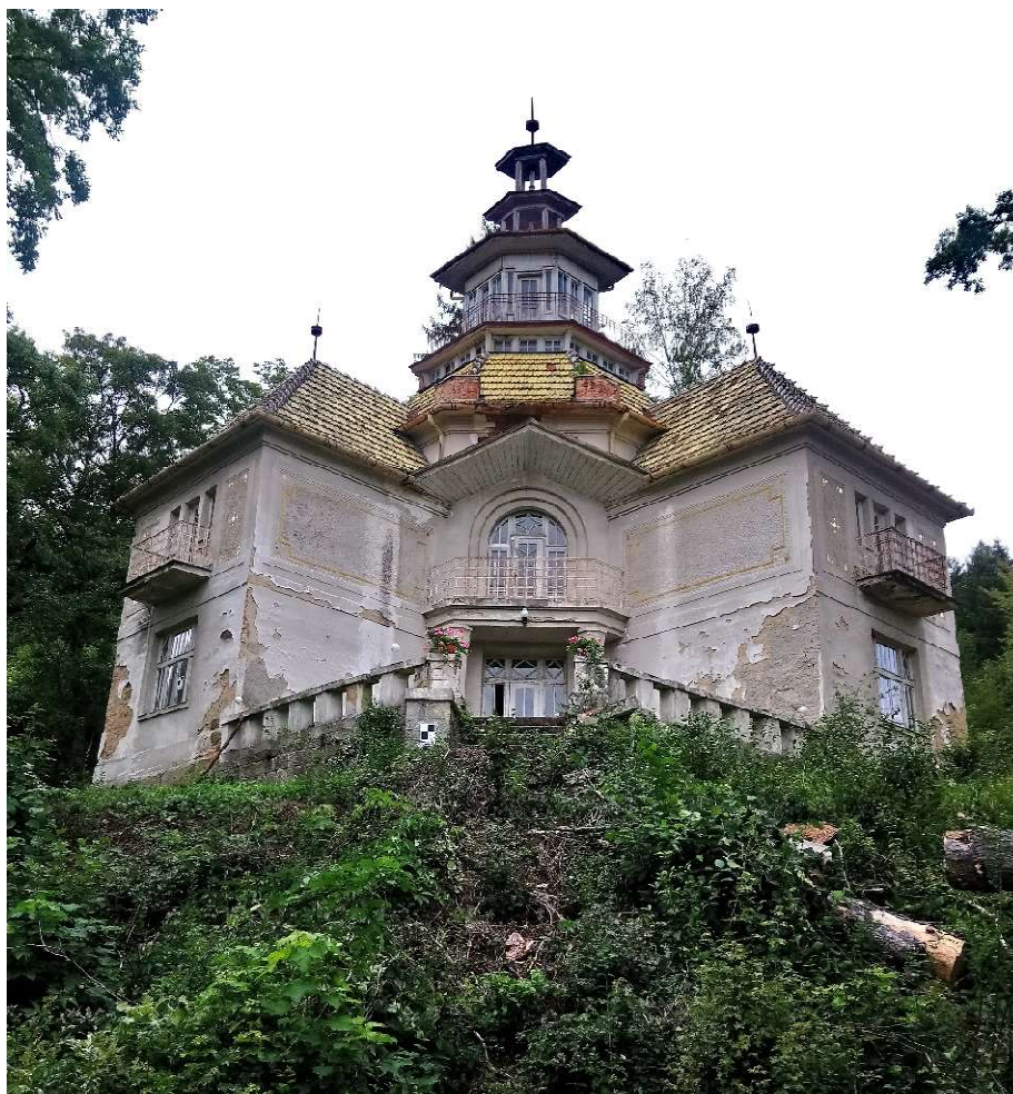
Obr. č. 7: Pohled na současný stav objektu od vstupní strany [foto: Ing. Hovorka]
