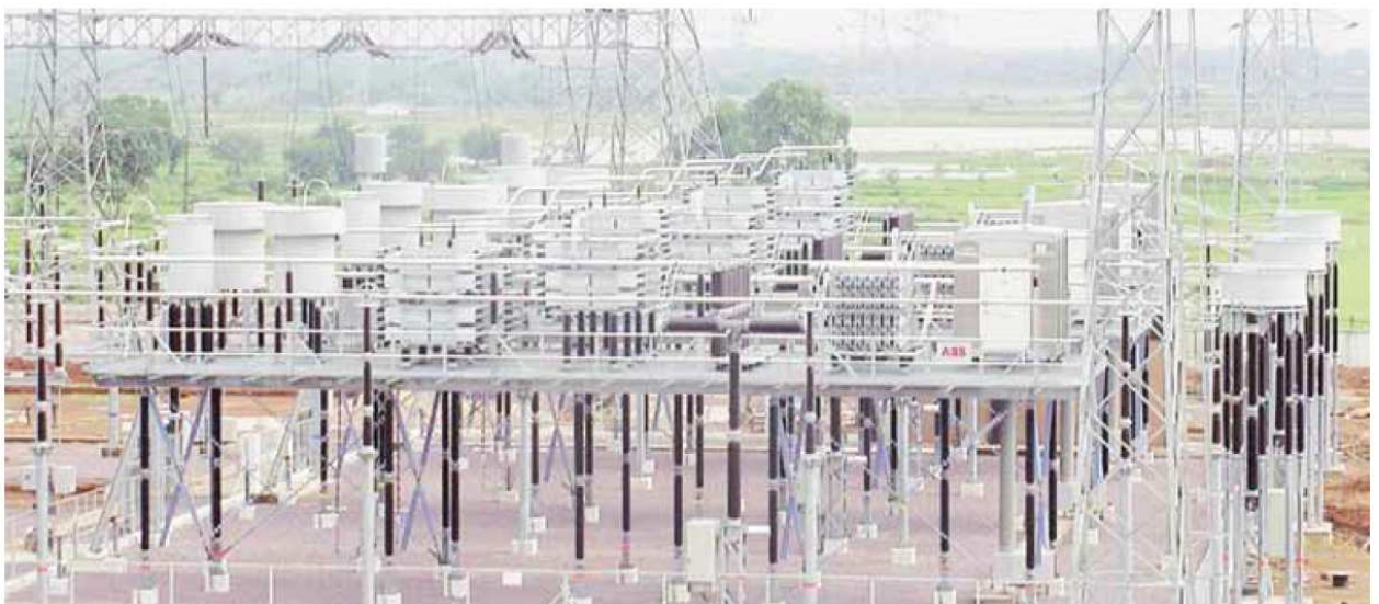
Obr. 4-3 Instalace zařízení TCSC v rozvodně Raipur (Indie) [9]
