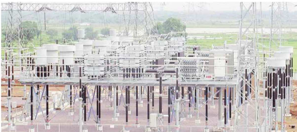
Obr. 4-3 Instalace zařízení TCSC v rozvodně Raipur (Indie) [9]
