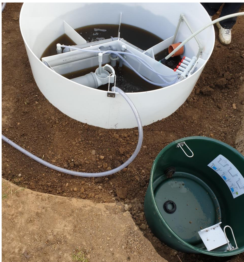
Obr. 4-1 Nainstalovaná domovní ČOV AQUATEC AT6 s šachtou na dmychadlo
