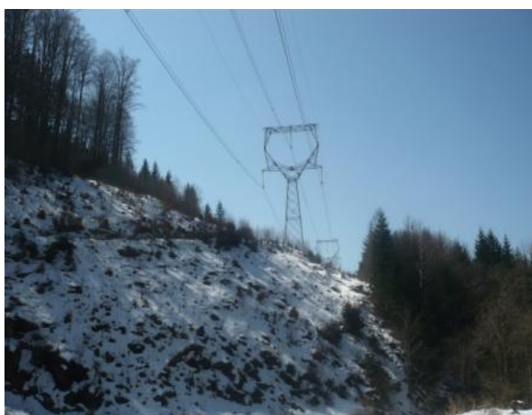
Obr. 21: Vedení vysokého napětí od PVE k rozvodně v Krasíkově (Zdroj: fotografie autora).
