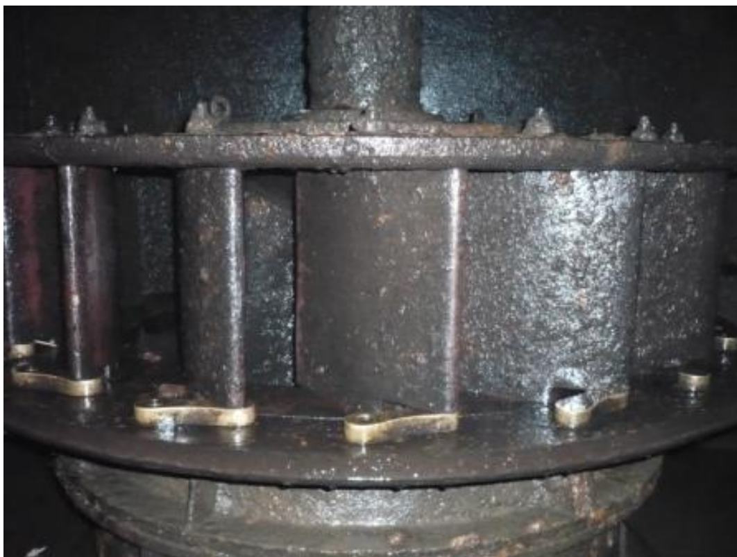
Obr. 15: Instalovaná Francisova turbína s detailem lopatek, jejichž naklápěním je možné regulovat výkon turbíny (Zdroj: fotografie autora).
