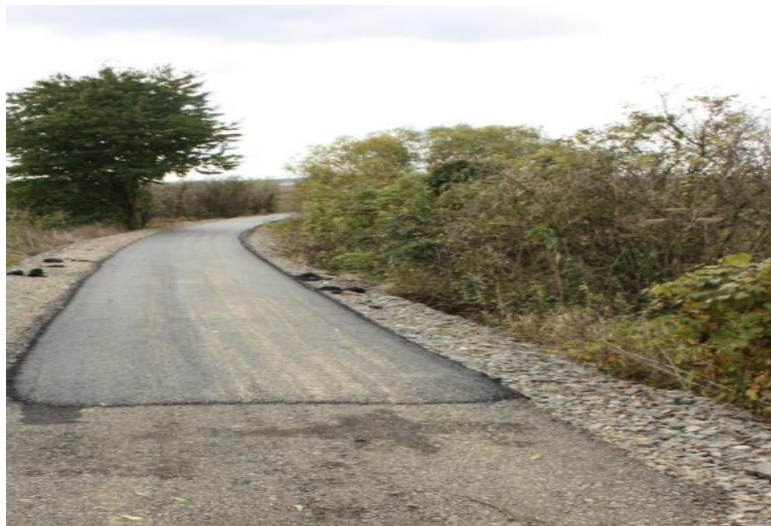
Obrázek 15: Nevhodná oprava cyklostezky (zdroj: DVS, ©2020)
