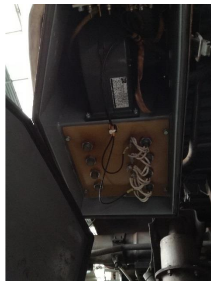
Obr. 9 – Ventilátor a přívody do boxu s topnými spirálami
