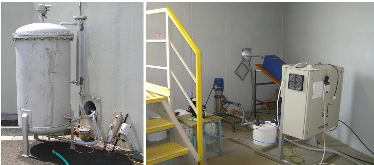
obr. 4.1 Poloprovozní ozonizační jednotka: vlevo reakční nádrž a destruktor ozonu; vpravo ozonizátor, UV lampa, čerpadlo, injektor a dávkovací čerpadlo H_2O_2
