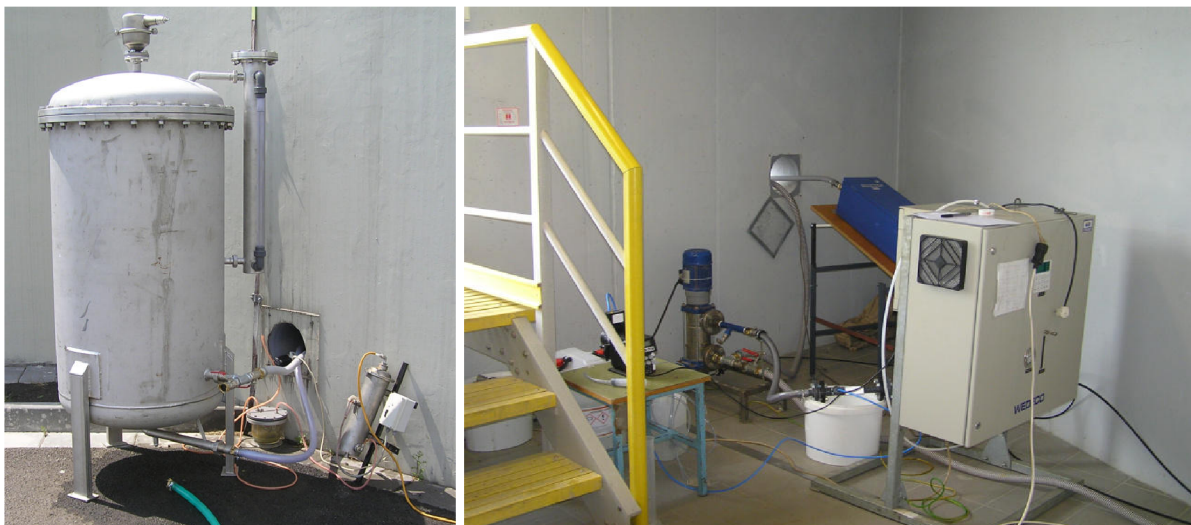
obr. 4.1 Poloprovozní ozonizační jednotka: vlevo reakční nádrž a destruktor ozonu; vpravo ozonizátor, UV lampa, čerpadlo, injektor a dávkovací čerpadlo H 2 O 2
