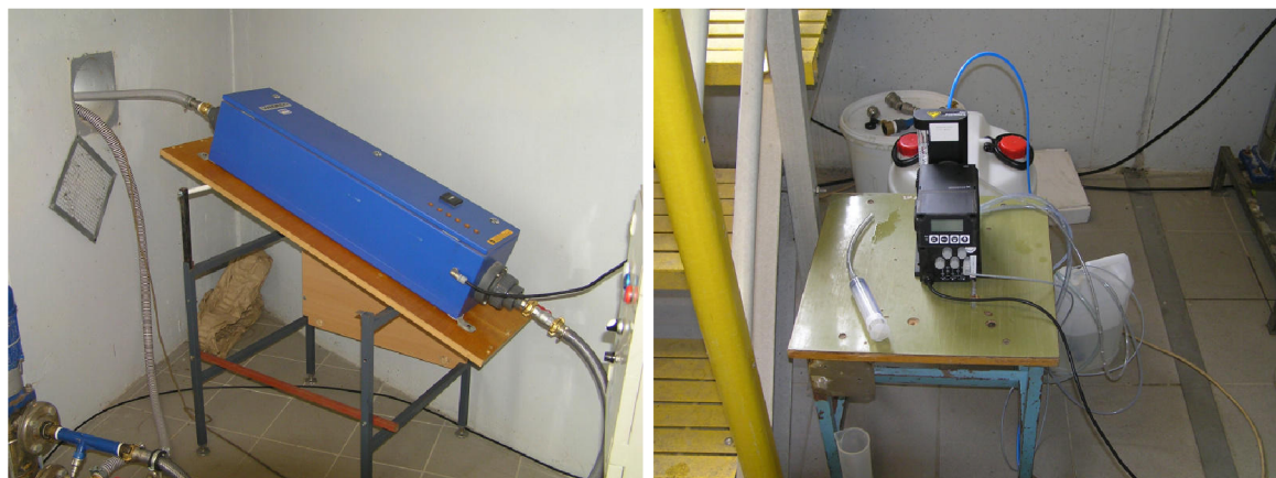
obr. 4.2 Poloprovozní ozonizační jednotka: vlevo UV lampa; vpravo dávkovací čerpadlo H 2 O 2
